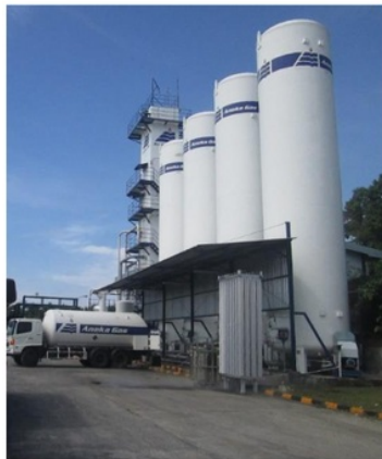
Gambar 1 Bejana tekan di PT. Aneka Gas Industri
