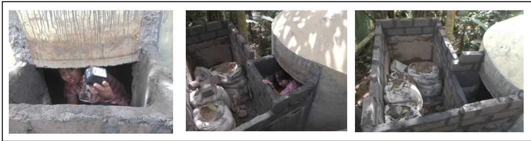
Gambar 5. Pembangunan Main Hall dan Outlet dari Digester Tipe fixed dome di Atas Tanah
