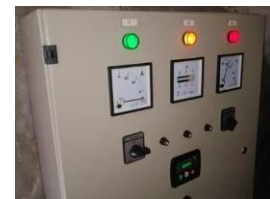
Gambar 2.4 Panel Distribusi Listrik.
