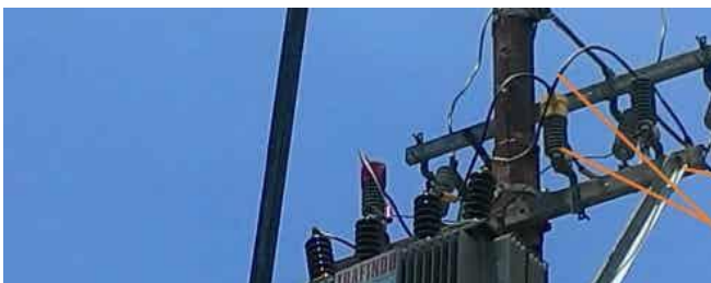
Gambar 2. 3 Dudukan fuse cut out
