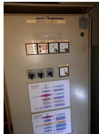
Gambar 1. Rectifier di Gardu Induk Teling
