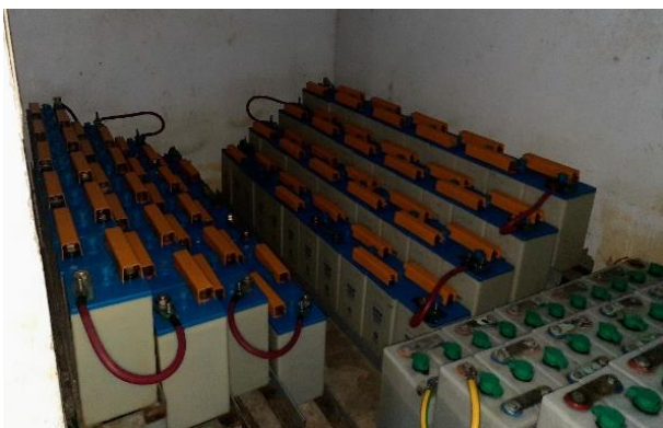
Gambar 2. Baterai di Gardu Induk Teling
