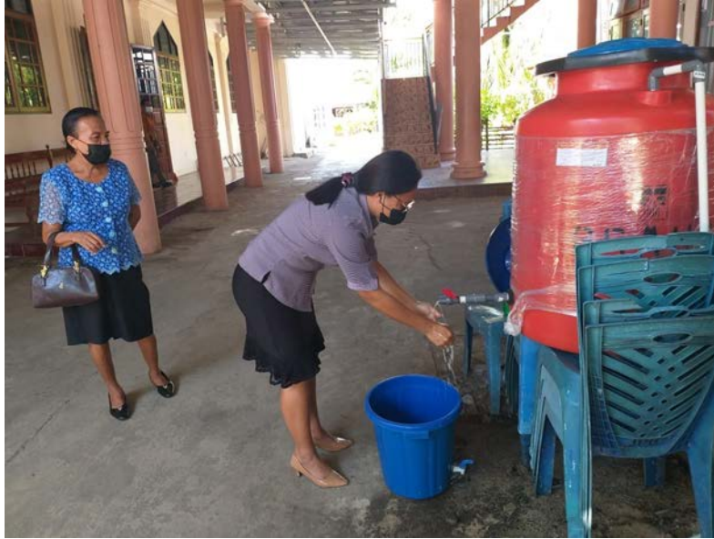
Gambar 10. Penerapan TTG pompa air tenaga surya untuk suplai air pada alat cuci tangan di fasilitas umum di Pulau Bunaken
