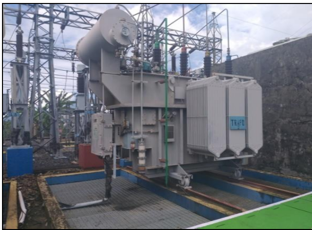
Gambar 2 Transformator 2 pada GI Teling
