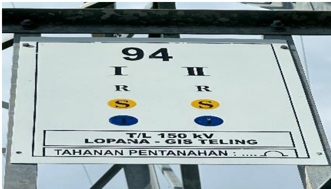
Gambar 16. Plat Informasi Tower (T094-T096)
