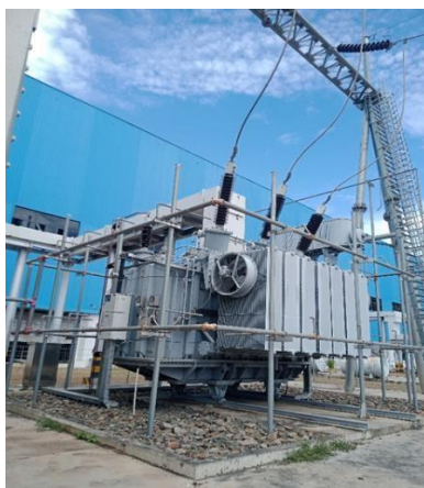
Gambar 2 Transformator 1 pada PLTU SULUT-3
