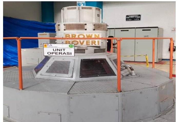
gambar 2 Generator pada PLTA Tonselama
