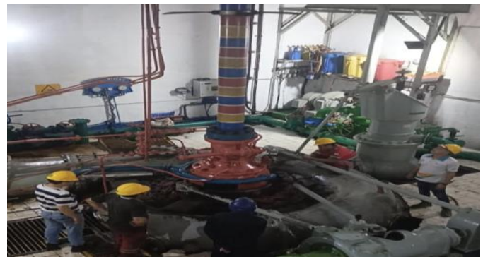
gambar 3 Turbin Air pada PLTA Tonselama dalam sebuah cincin yang berbentuk spiral atau rumah keong [12].
