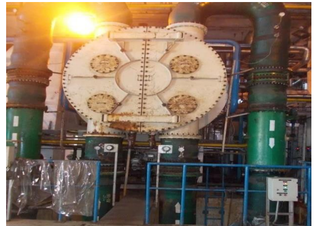
Gambar 5. Condensor pada PLTU 2 Sulawesi Utara
