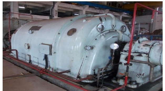
Gambar 4. Generator pada PLTU 2 Sulawesi Utara
